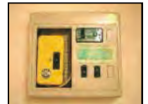
電気ブレーカー
